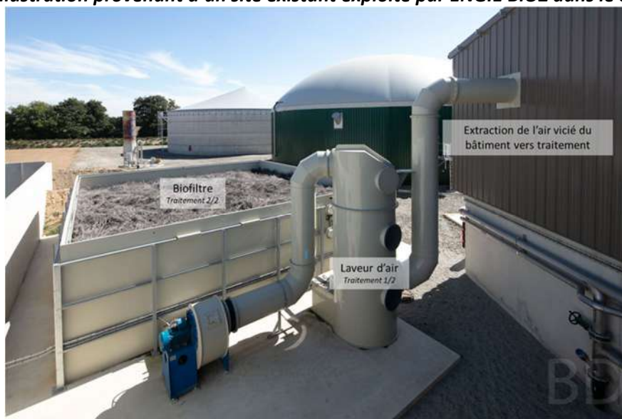
Illustration provenant d'un site existant exploité par ENGIE BiOZ dans le 85
